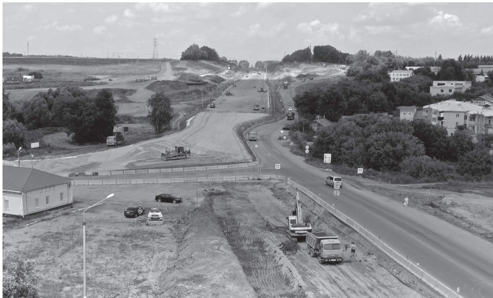
Считанные месяцы остаются до сдачи объекта в эксплуатацию (фото от 3 июля 2024 года)
